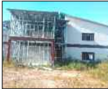
रिखणीखाल ब्लाक के बड़खेत में खंडहर पड़ा पालीटेक्निक कालेज भवन
