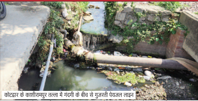
कोटद्वार के काशीरामपुर तल्ला में गंदगी के बीच से गुजरती पेयजल लाइन
